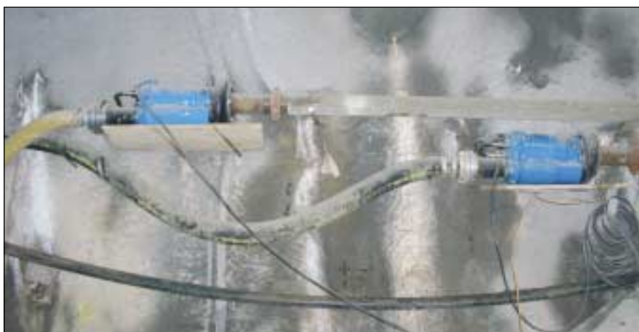
Pompe orizzontali di potenziamento nella Galleria Bleßberg
