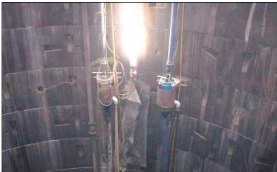
Quattro piccole pompe Tsurumi installate in serie sono tutto ciò che serve per assicurare il drenaggio verticale in alto per tutta la galleria
